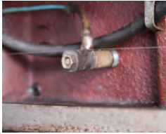
給電ブロック
